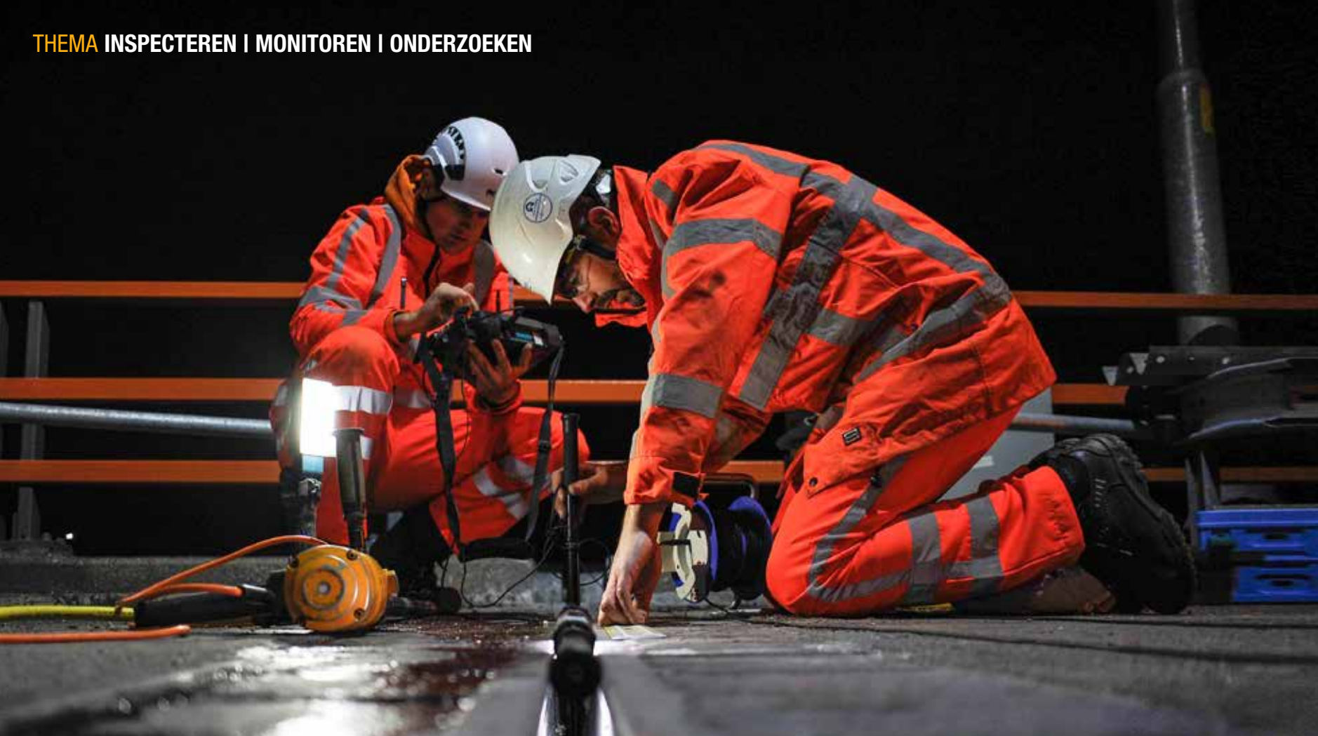
Aan een voegopening van slechts 4 cm hebben de inspecteurs van Concept Ingenieurs voldoende om gericht technisch onderzoek uit te voeren.
