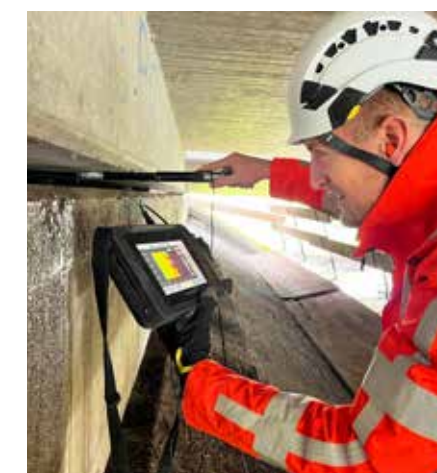
Soms is het moeilijk om op basis van enkel een visuele inspectie tot een diagnose te komen ten aanzien van de staat van onderhoud van een kunstwerk. De specialistische apparatuur van Concept Ingenieurs biedt dan soelaas.
