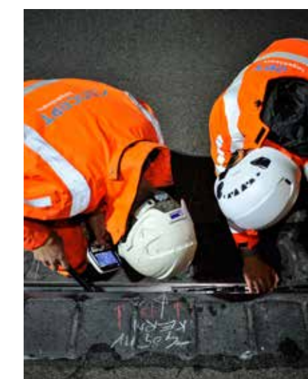
Chloriden vormen een bedreiging voor de wapening en overige stalen onderdelen onder de voegovergang.
